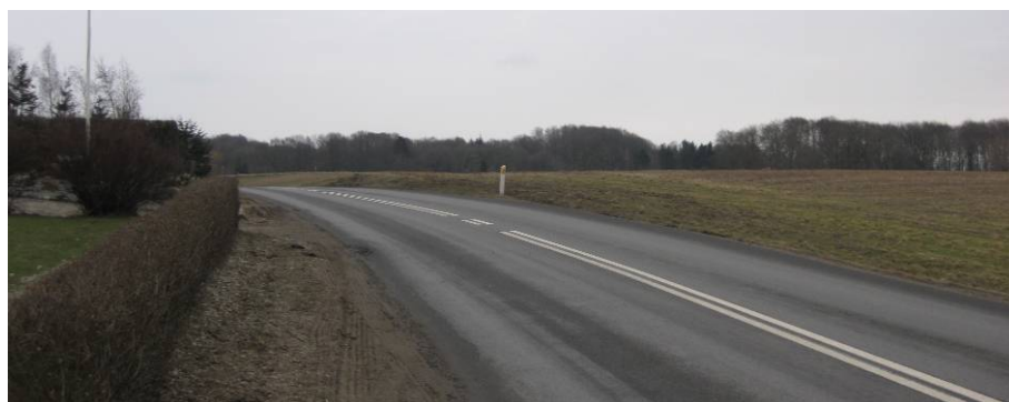
Figur 3. Dårlig oversigt. 7 ejendomme på Ballevej har trafikfarlige adgangsforhold.
